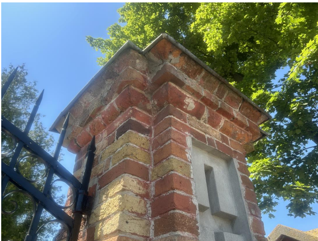
Fot. 3. Słup bramy wjazdowej, część górna, widoczne uszkodzenia wysuniętych partii detalu ceglanego pod obróbką blacharską czapki słupa oraz nisza.
