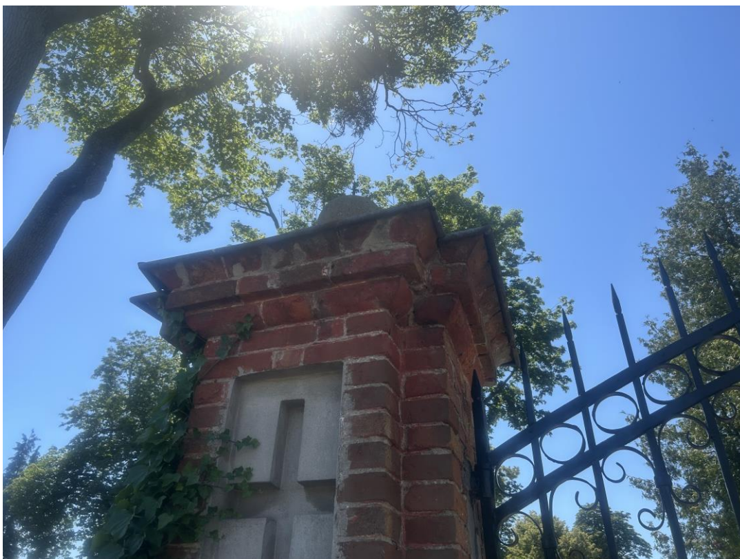
Fot. 5. Słup bramy wjazdowej, część górna, strona zewnętrzna. Widoczne uszkodzenia pod linię obróbki blacharskiej oraz porastający bluszcz.
