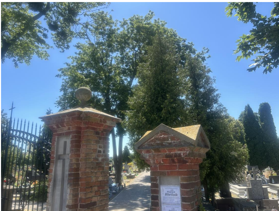
Fot. 7. Słup bramy wjazdowej i słup ogrodzenia. Widoczne wykończenie czapek-uszkodzona obróbka blacharska oraz czapka cementowa o nadmiernej grubości.
