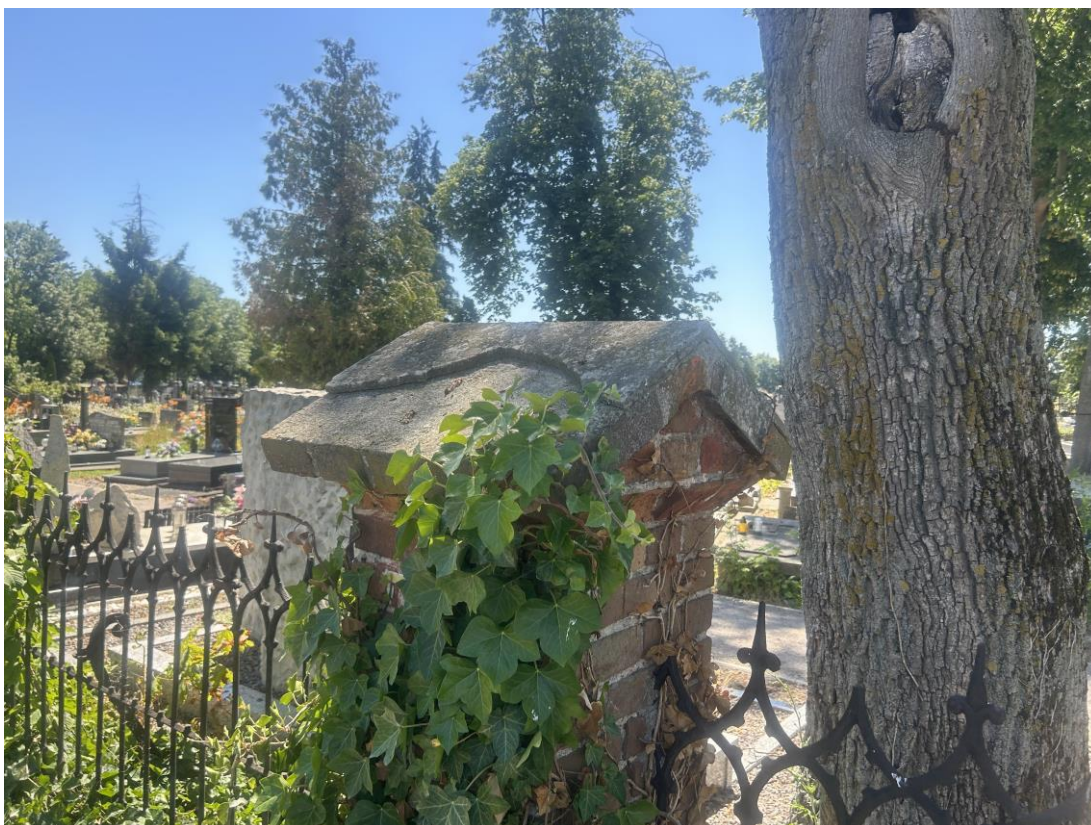
Fot. 9. Słup ogrodzenia, widoczna nadłana czapka cementowa.
