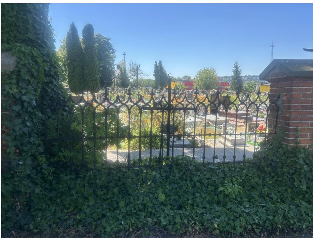
Fot. 8. Przęsło metalowe ogrodzenia. Widoczna skala problemu wynikającego z porostania przez bluszcz.
