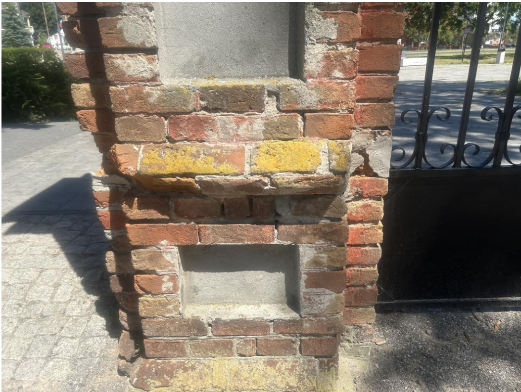
Fot. 2. Słup bramy wjazdowej, widoczne uszkodzenia spowodowane zaciekaniami wody opadowej oraz eksploatacyjne (widok od wewnątrz).
