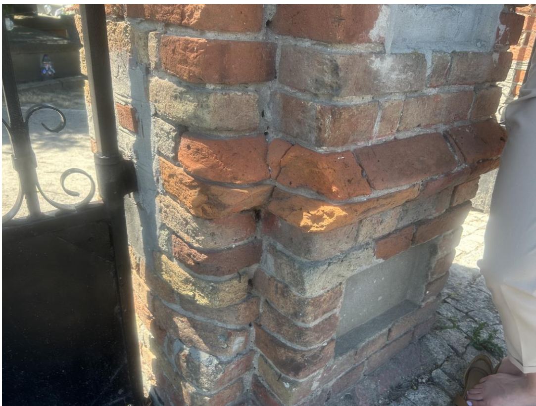
Fot. 4. Słup bramy wjazdowej, część dolna, od strony zewnętrznej. Widoczne uszkodzenia spowodowane zaciekananiem wody opadowej.
