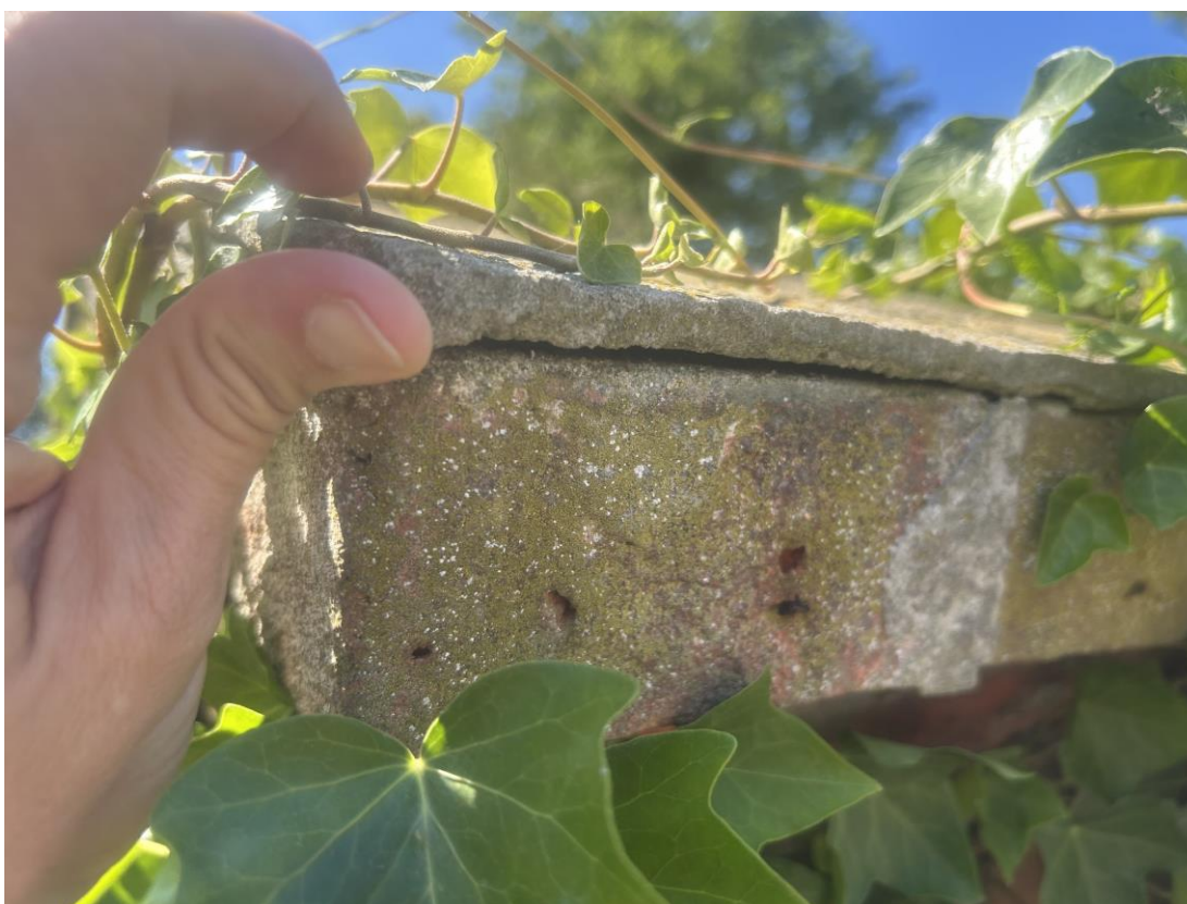
Fot. 10. Odsypająca się nadlewka na czapce słupa ogrodzeniowego.
