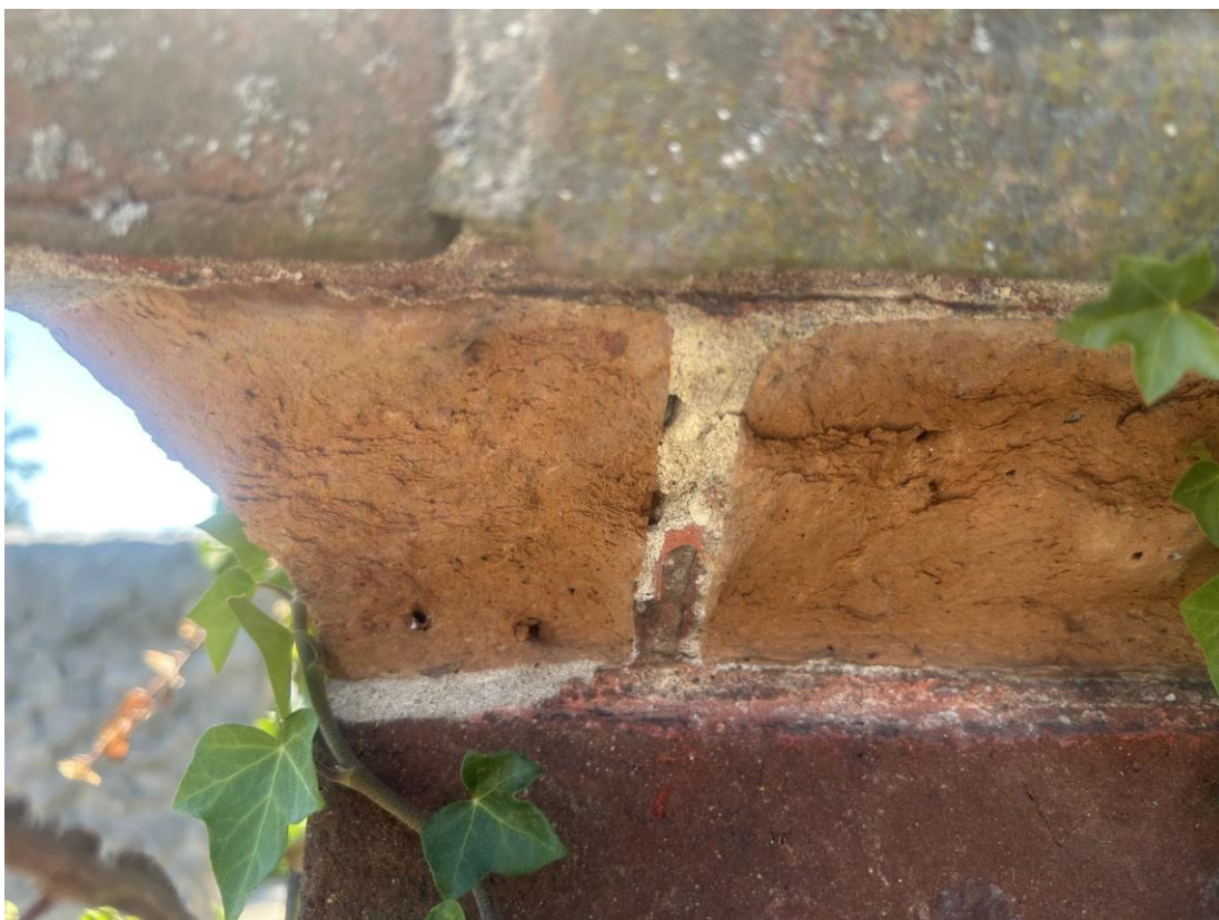
Fot. 13. Cegła pod linia czapki słupa ogrodzeniowego. Widoczna degradacja w formie pudrującej się powierzchni i złuszczeń oraz wykruszeń spoiny.
