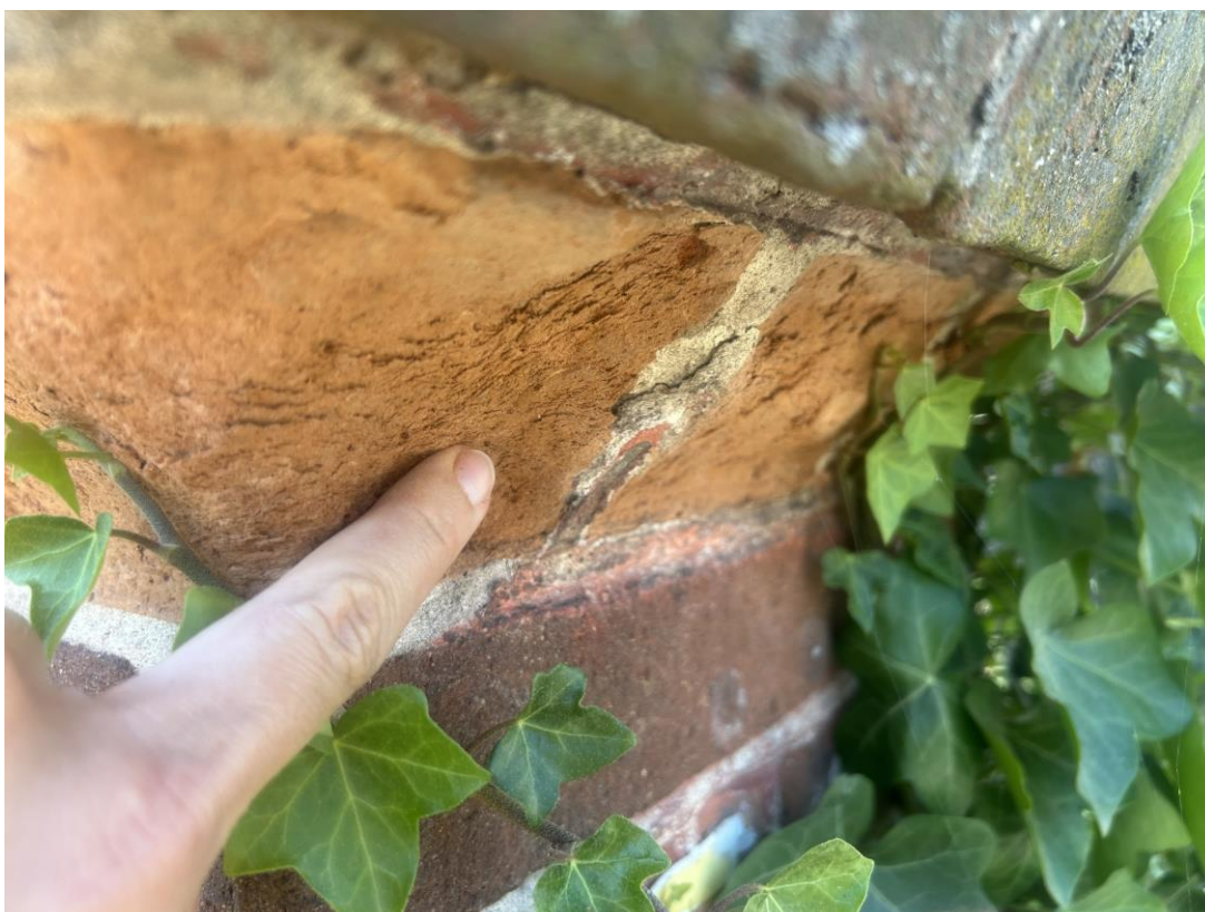
Fot. 12. Cegła poniżej czapki stupa ogrodzeniowego. Widoczna degradacja i tuszczenie się cegły.
